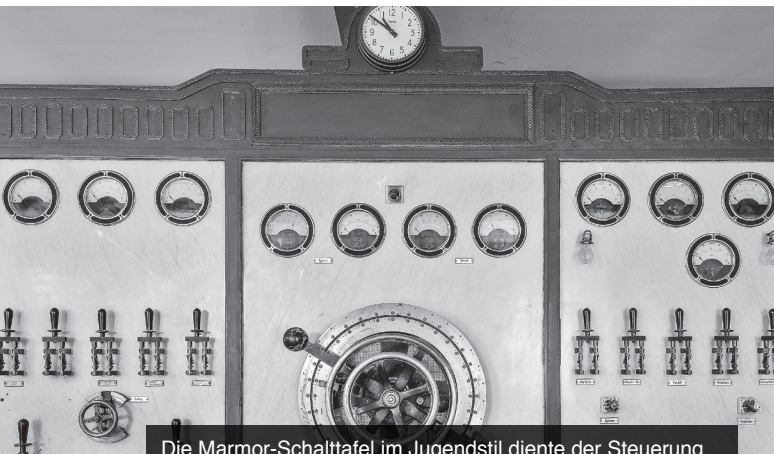
Die Marmor-Schalttafel im Jugendstil diente der Steuerung der Batterieanlage und der Belichtung der Websäle. Die heute seltenen Messgräte stammten von der Firma Trüb, Täuber & Co. (Bild Roland Mosimann)
