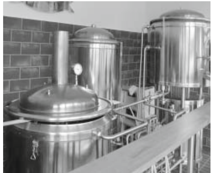
Abb. 25 Bild der Brauanlage in Rued mit 250 Liter Fassungsvermögen. Quelle: https://www.brauhaus-austria.com/de/referenzen/details/Schloss-Rued.html
